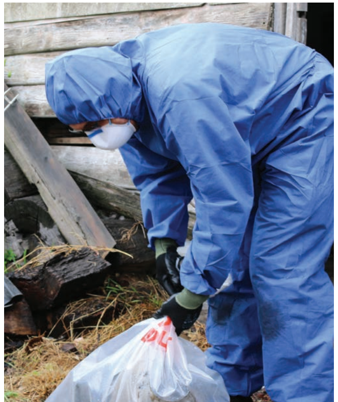
處理含有石棉的材料期間，須時刻穿戴防護裝備，並且處理後將該類裝備棄置。
